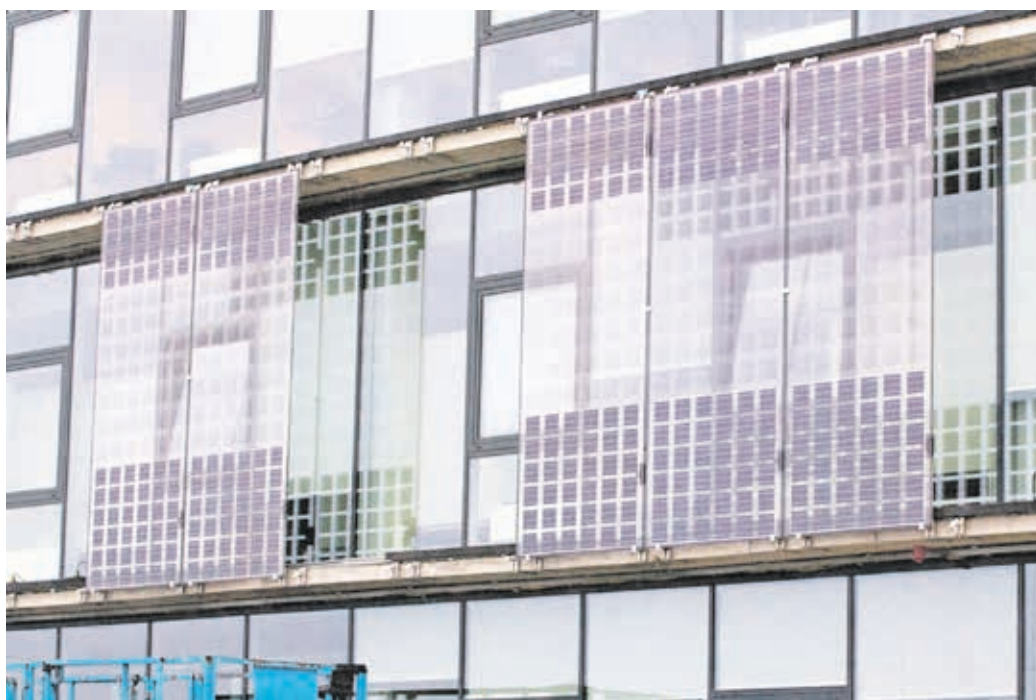
Die Glas-Glas-Module produzieren rund 12,5 Megawattstunden Strom jährlich.
